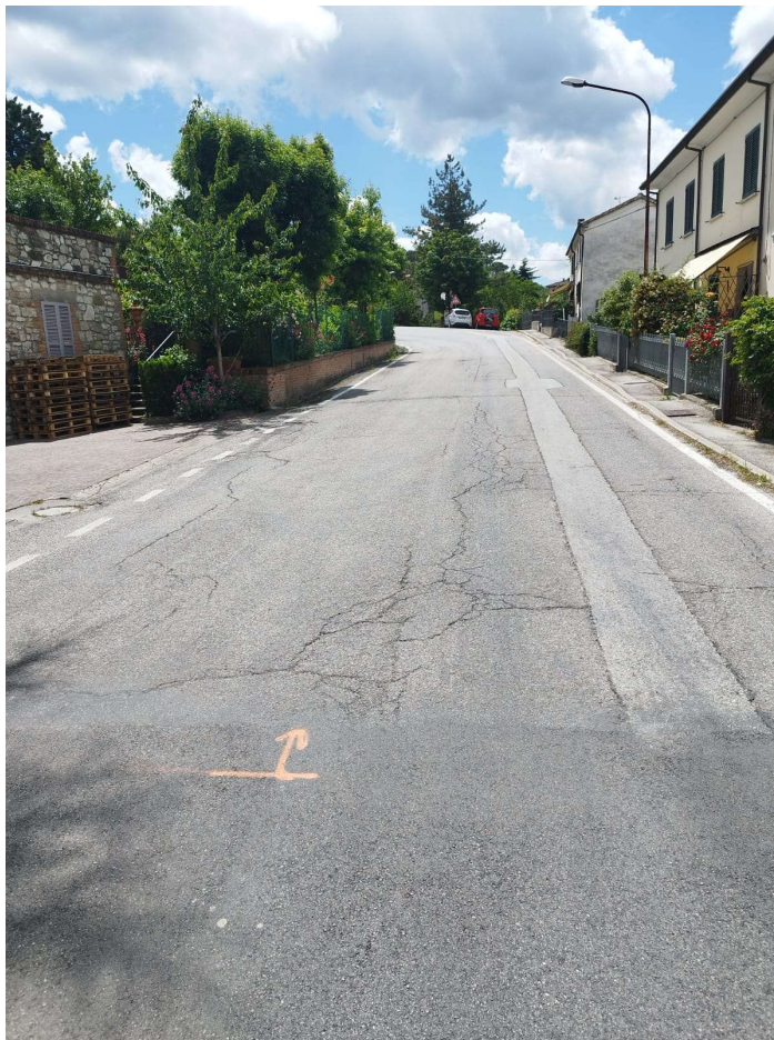
FOTO 4 - S.P.N.2 "CONCA" KM 14+350 - ante intervento e post intervento
