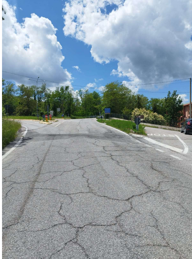
FOTO 3 - S.P.N.2 “CONCA” KM 14+950 - ante intervento e post intervento
