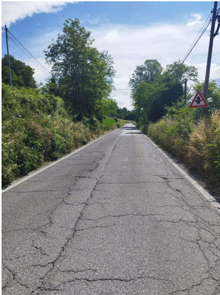
FOTO 5 - S.P.N.2 "CONCA" KM 11+630 - ante intervento e post intervento
