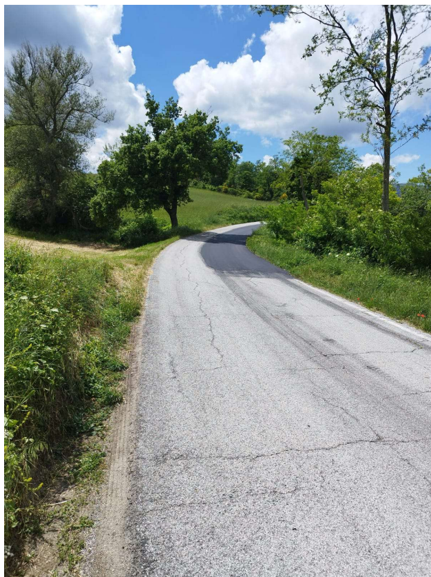
FOTO 2 - S.P.N.2 "CONCA" KM 15+730 - ante intervento e post intervento
