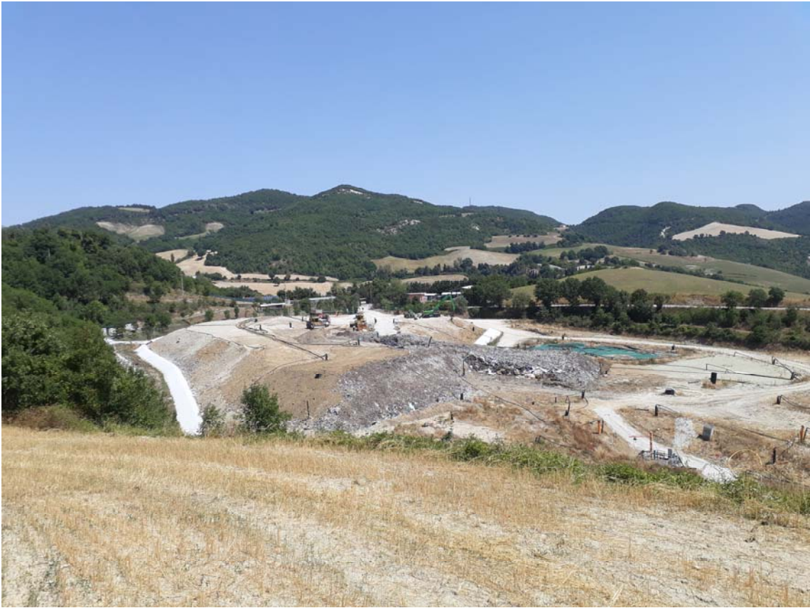
Figura 4: Vista dell'impianto da Sud Ovest
