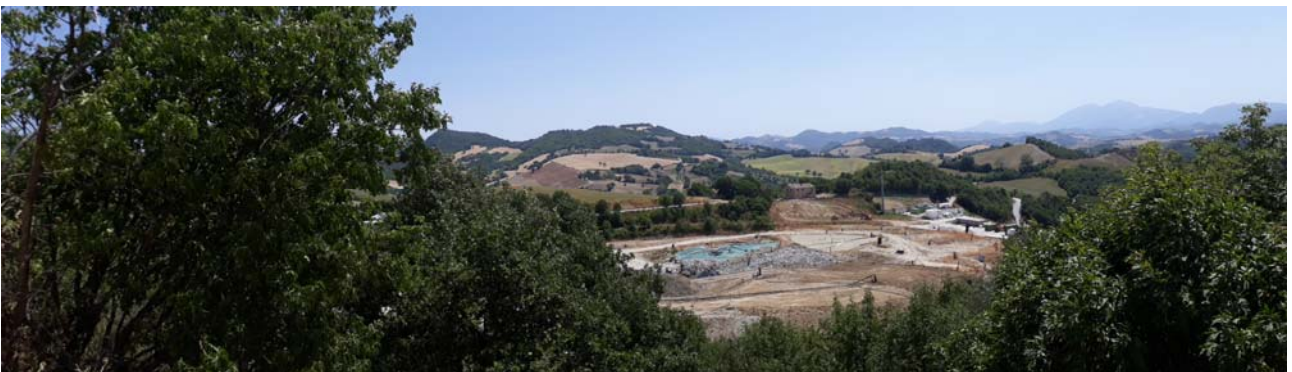
Figura 3: Vista dell'impianto da Sud
