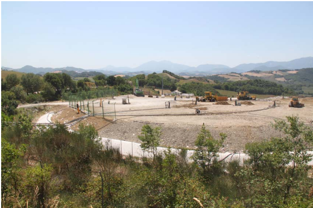
Figura 5: Vista dell'impianto da Nord Est
