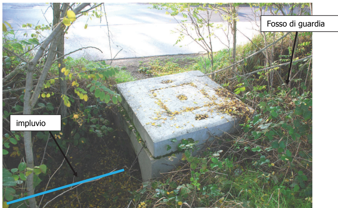
FOTOGRAFIA DEL POZZETTO 1
