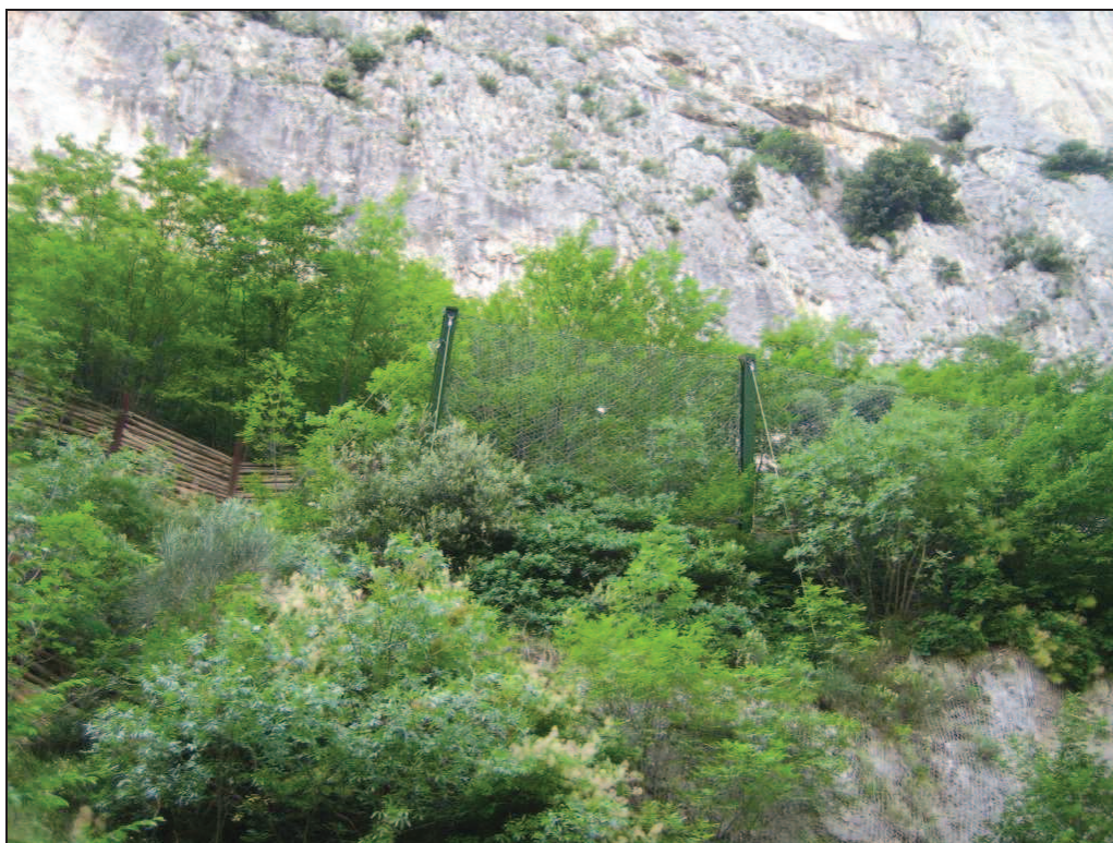
Foto 1: Barriera paramassi, pannelli di rete in fune d'acciaio e palizzate in legno.
